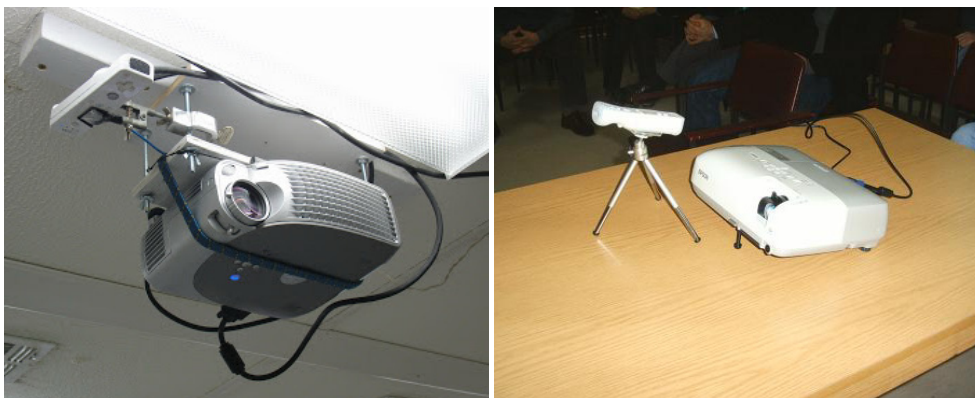
Slika 6: Primeri postavljanja opreme
